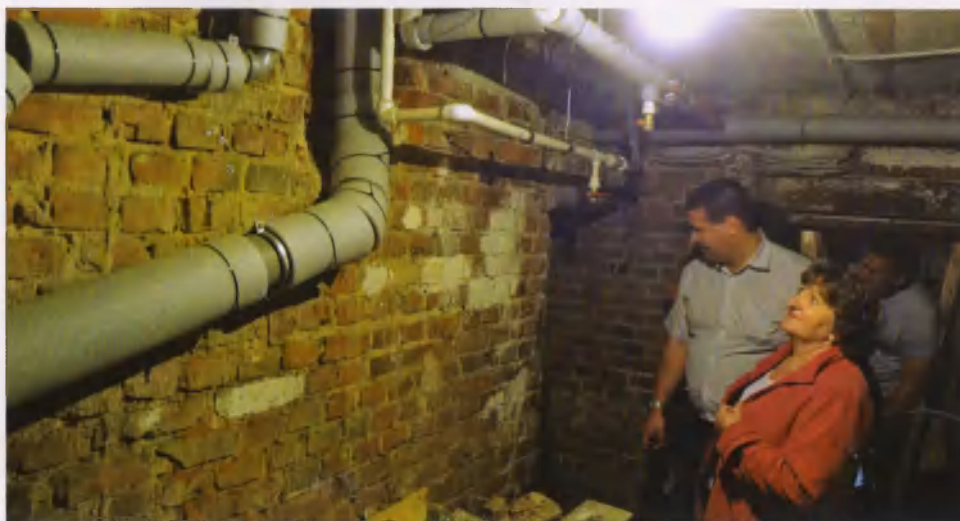
Комиссия с участием представителей РЦОК оценивает качество ремонта ХВС, ГВС и системы водоотведения в доме 15 по ул. Угличской в Ярославле (июнь 2015 г.)
