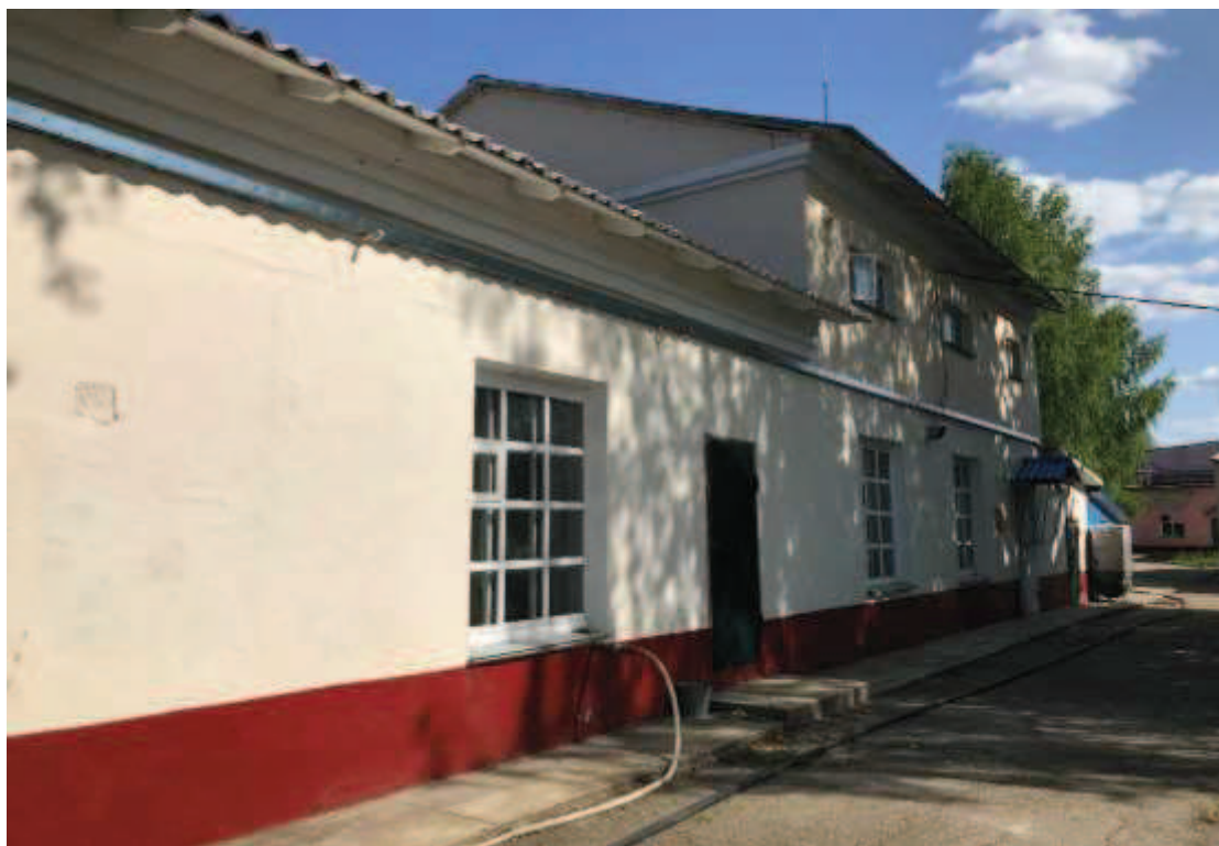
Фото: насосная станция
